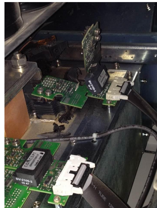
逆变器IGBT模块炸裂
